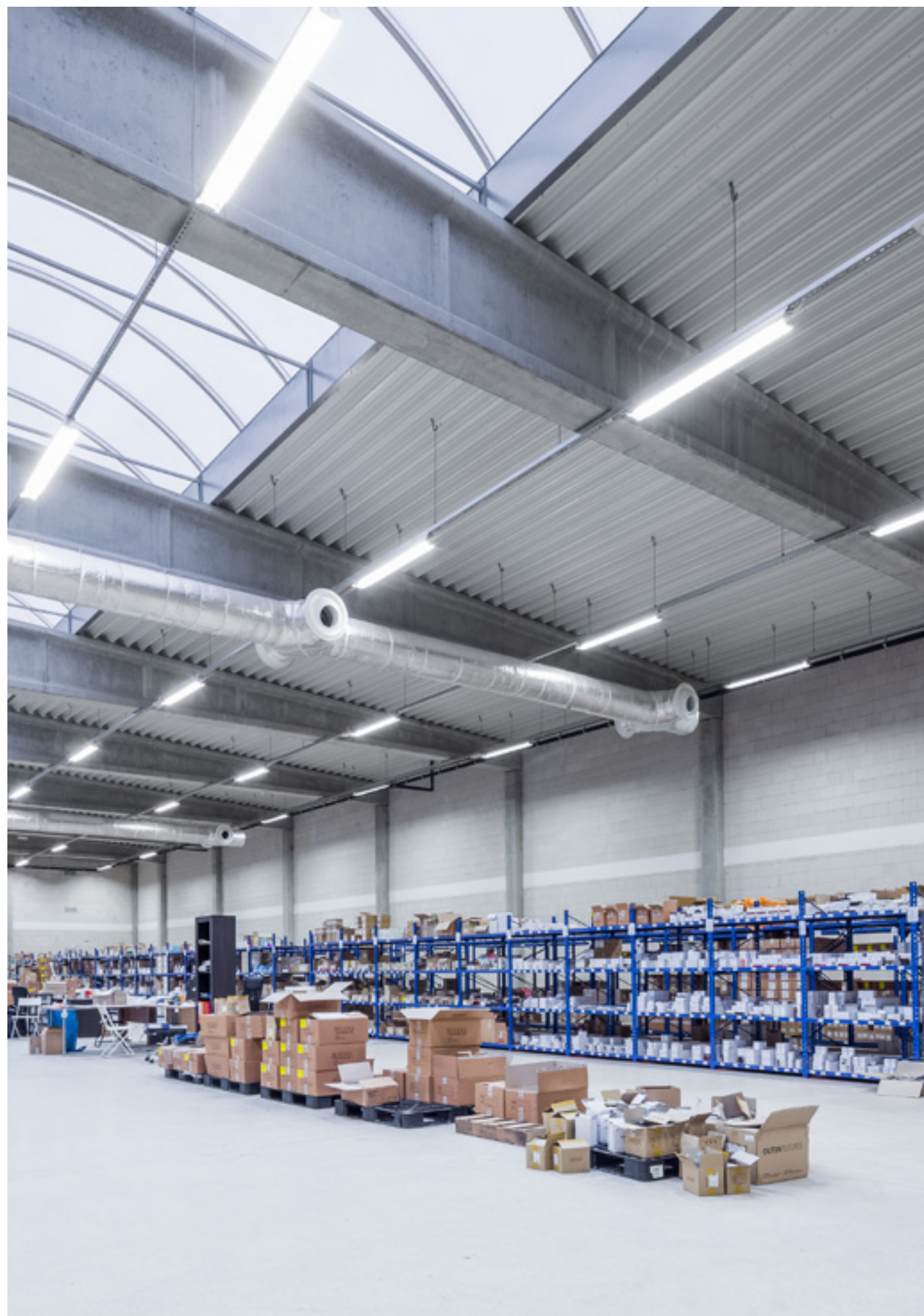
Zastosowanie lamp Tores LED PC w hali magazynowej
