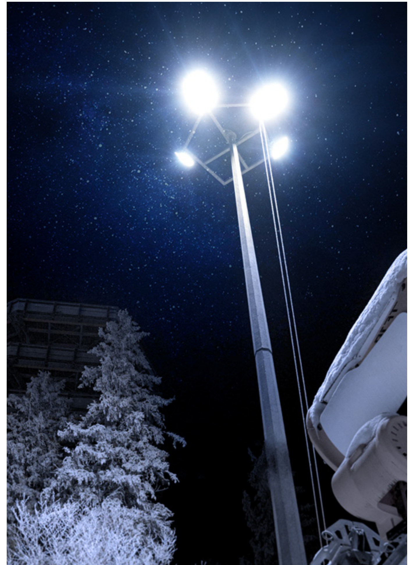
Oświetlenie stoku narciarskiego Stotwiny Arena
